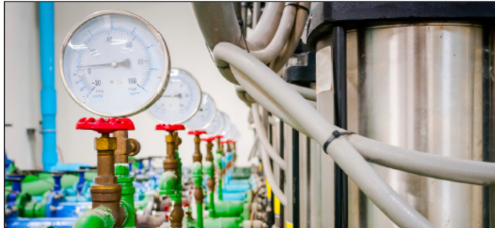
Med digital datahantering får fastighetsförvaltare mycket bättre kontroll över energiförbrukningen.
